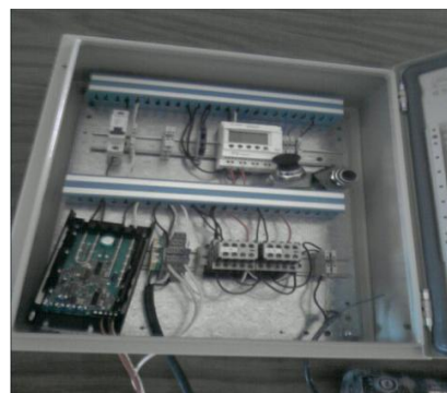
Figura 7. Panel de control eléctrico.
